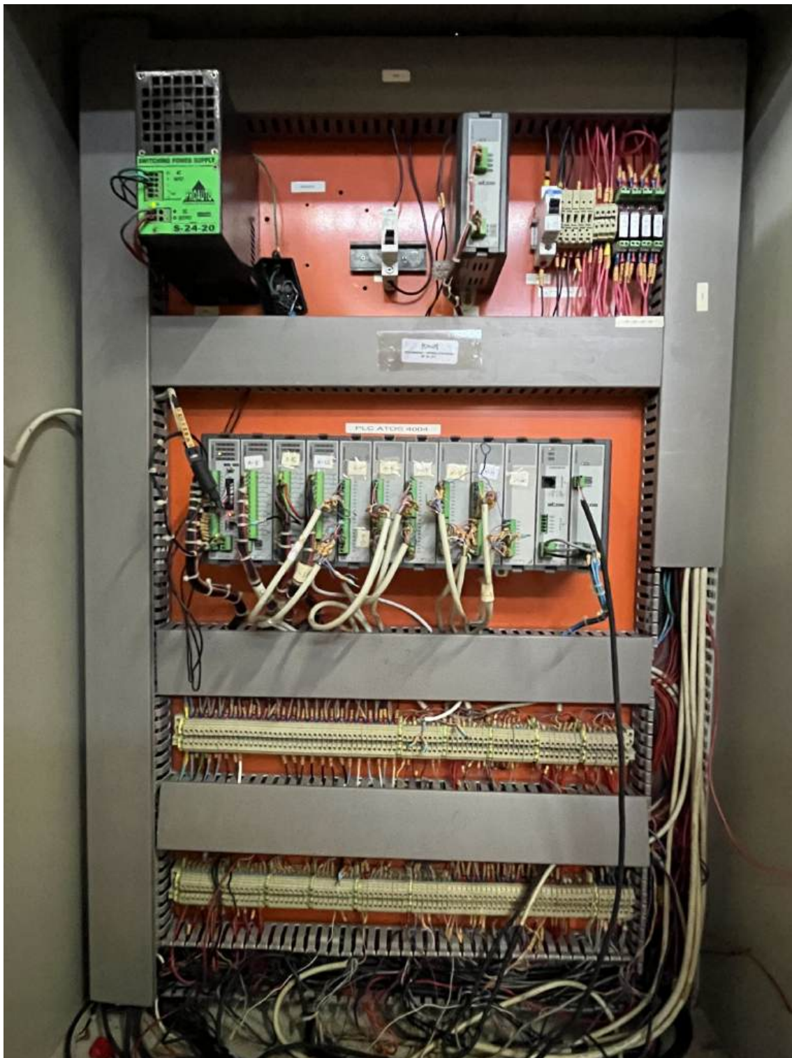
Figura 5.6 - Controlador Lógico Programável (CLP).
