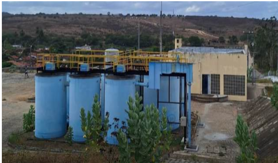
Figura 4 – Estação de tratamento de água.
