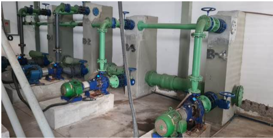
Figura 14 – Casa de bombas.
