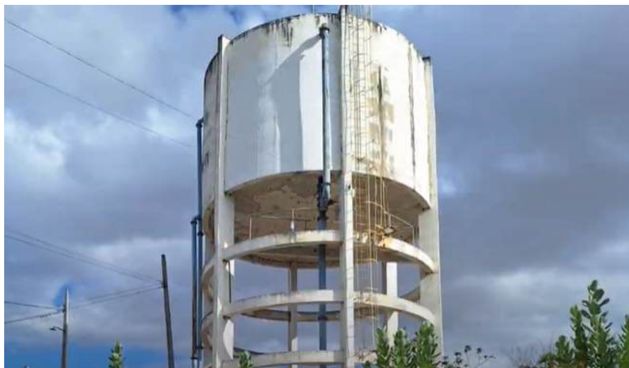
Figura 5 – Reservatório elevado de água.
