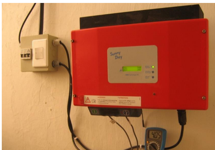
Figura 59. Inversor de potência, SonnyBoy 1100, de um sistema fotovoltaico montados no CEAR/UFPB, João Pessoa - PB. Fonte: Guillermo Andrés Rodríguez Cantor. Acervo pessoal.
